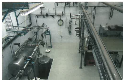
Salle d'essais équipements cryogéniques IN-LHC Chateaudun
